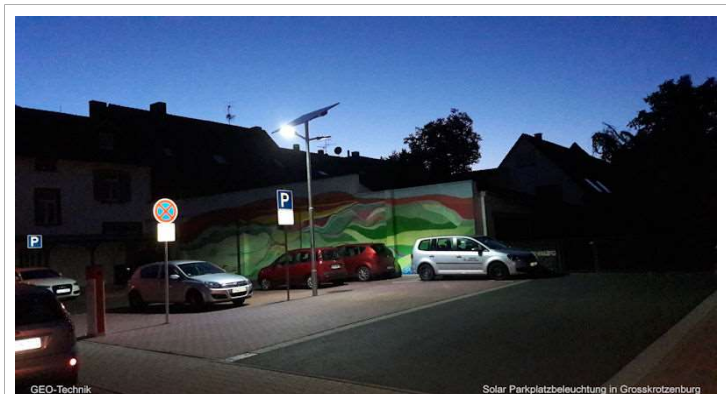
Doppelseitige Solarleuchte für Parkplatz am Rathaus Großkrotzenburg Double sided solar light for municipal parking lot, Germany
